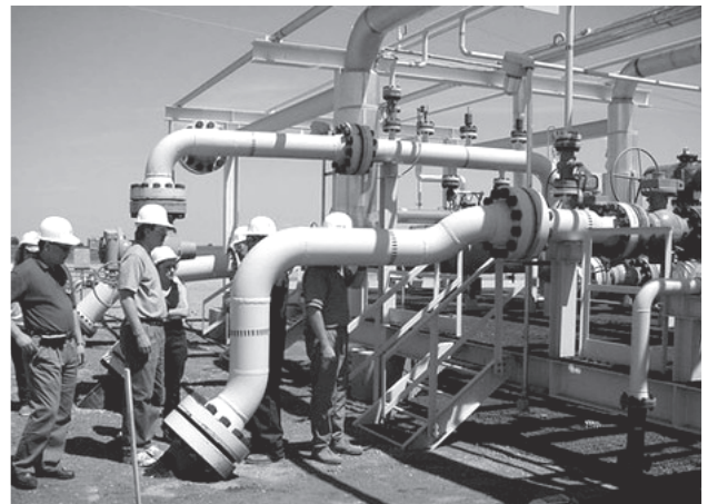
Kohlendioxid-Pipeline im Weyburn-Ölfeld (Foto: PTRC)
