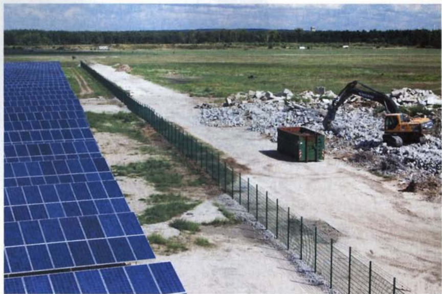
Der Boden, auf dem der Solarpark heute steht, wurde förmlich umgegraben. Das hat ökologische Narben hinterlassen. Wie sie verheilen werden, ist noch unklar.
