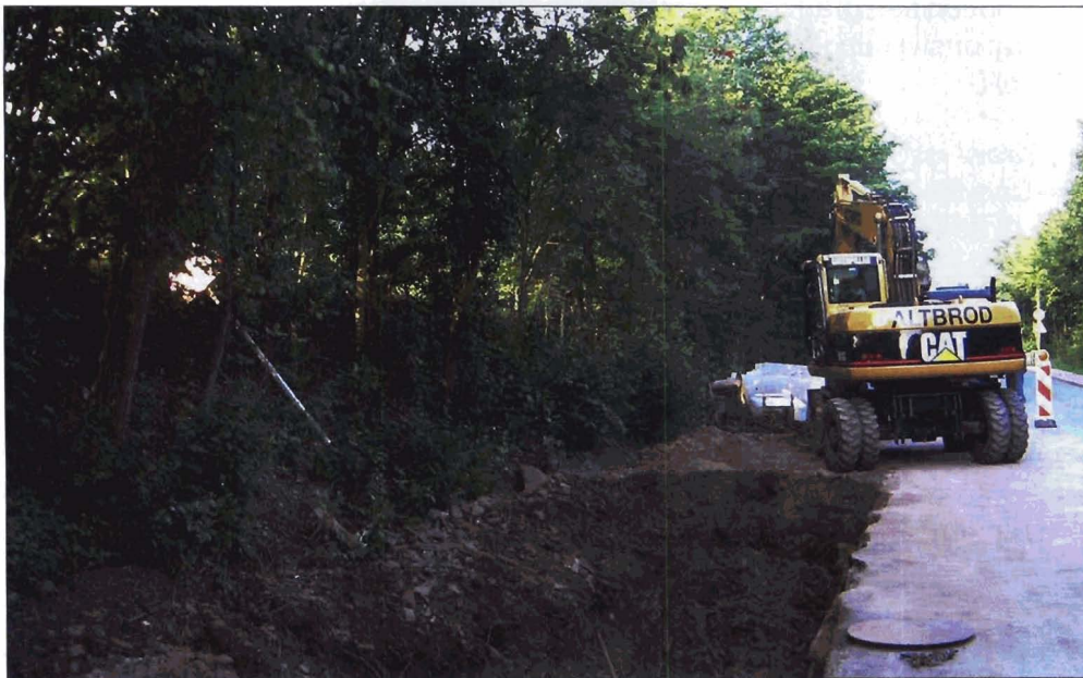
Abb. P 20: Der Ausbau von Straßen (insbesondere Verbreiterung) wird häufig als Fall unwesentlicher Bedeutung eingestuft.
